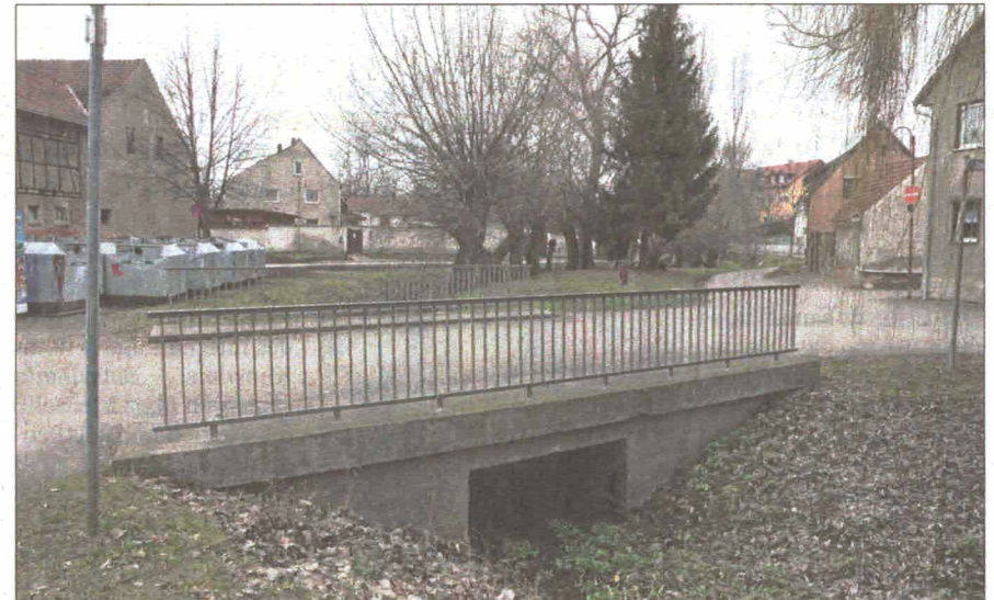
Die Trolle-Brücke im Herzen von Büßleben soll ab Juni abgerissen werden. Ob es einen Ersatzbau geben wird, muss sich bald entscheiden.
